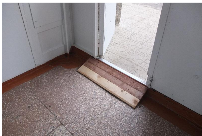
Rampă temporară construită peste pragul de la ușa de la intrare. (Secția de votare nr. 52 mun. Bălți, Școala profesională nr. 4)
