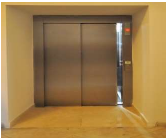
Foto nr. 18 Ascensorul din sediul Primăriei Chișinău
