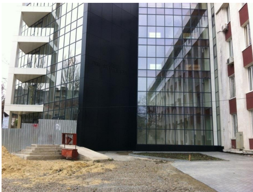
Rampa proiectată și construită în fața anexei Curții de Apel, Chișinău, este aproape de 2 ori mai scurtă decît prevăd Normativele
