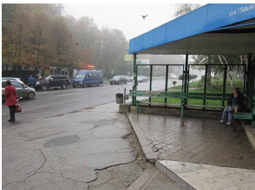
Bordura împiedică accesul sub acoperișul stație pentru persoanele în scaun rulant
