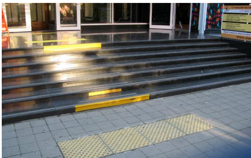
Figura 5: Exemplu de instalare a pavajului tactil de avertizare în fața scărilor de la intrare în clădire
